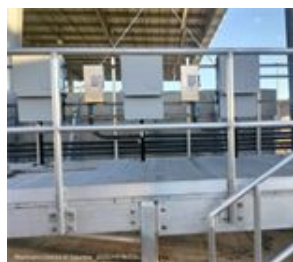
Conduit & Wire for Inverters
