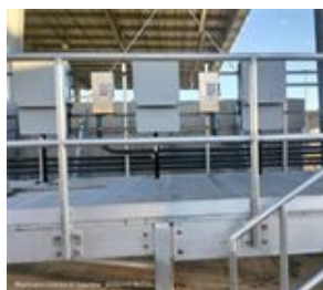
Conduit & Wire for Inverters
